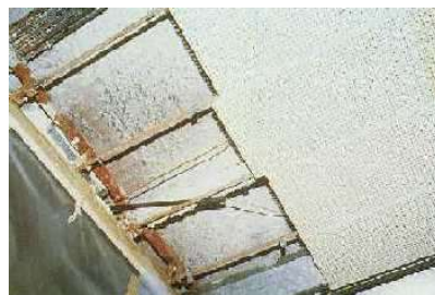
Amianto pannelli soffitto
